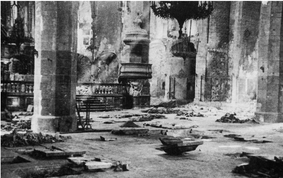
Nave central de la iglesia Santa María del Mar, incendiada, con posterior saqueo y violación de tumbas (Barcelona).
